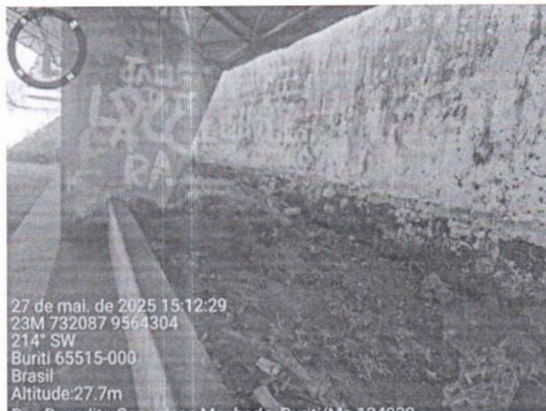
Figura 24 – Caneleta de drenagem pluvial não executada. Fonte: Fotografia in loco, elaboração própria.
